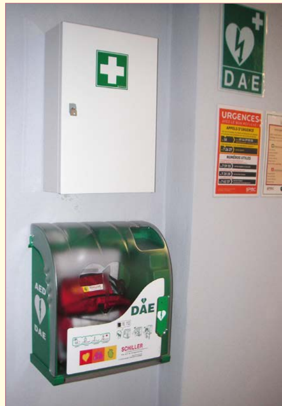
Défibrillateur automatisé externe (DAE) installé au rez-de-chaussée du laboratoire.
