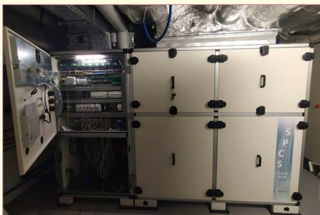
Système de traitement d'air des salles blanches avec son armoire en cours de câblage.
