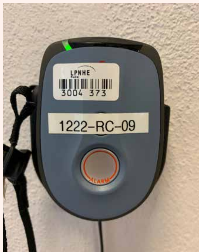
Un DATI est un "dispositif d'alarme du travailleur isolé". Il permet la détection de perte de verticalité et/ou d'immobilisme de l'agent qui le porte, et appelle le service sécurité incendie de Sorbonne Université le cas échéant.
